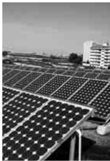
Impianto fotovoltaico installato sul tetto di una scuola del capoluogo ibleo
