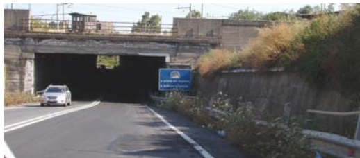
Una galleria al buio e il manto stradale pessimo (mt)
